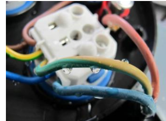
Wasser im Leitungsroller
