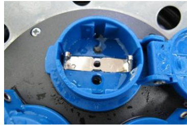
Wasser im Dosenbereich
