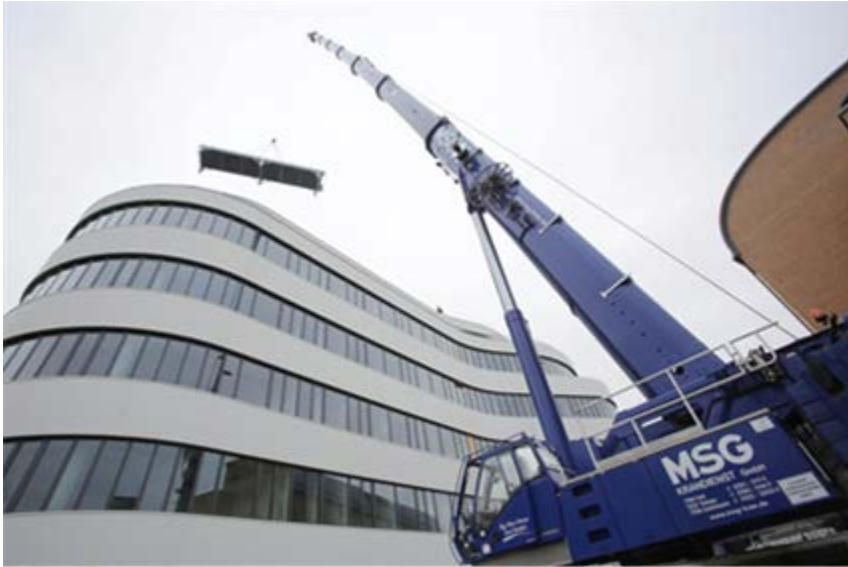
Abbildung 1: Installation der Rückkühlanlage auf dem Dach des SYNUS-Gebäude (Quelle: Stadtwerke Karlsruhe GmbH).
