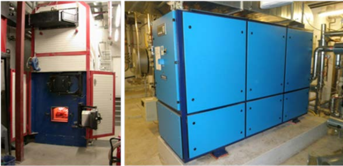
Abbildung 23 und 24: Links: Holzhackschnitzelheizung (Quelle: Stadt Stuttgart). Rechts: Blockheizkraftwerk (Quelle: Stadt Stuttgart).
