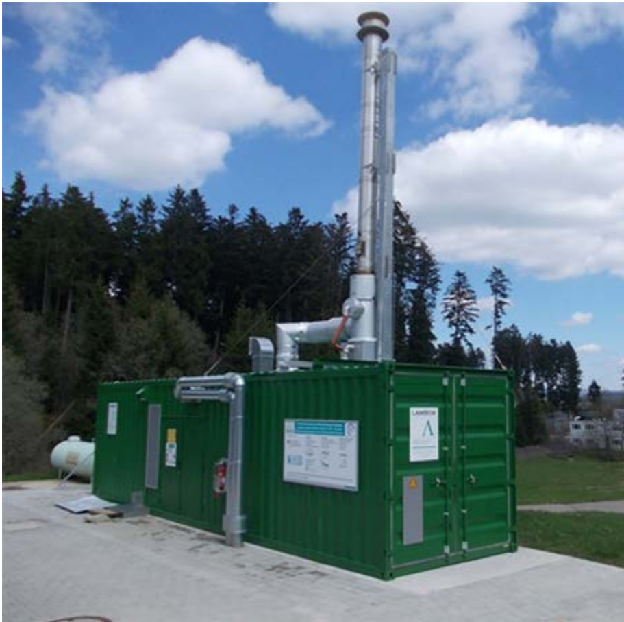
Abbildung 19: Anlage auf der Deponie Tuningen (Quelle: LRA Schwarzwald-Baar-Kreis).
