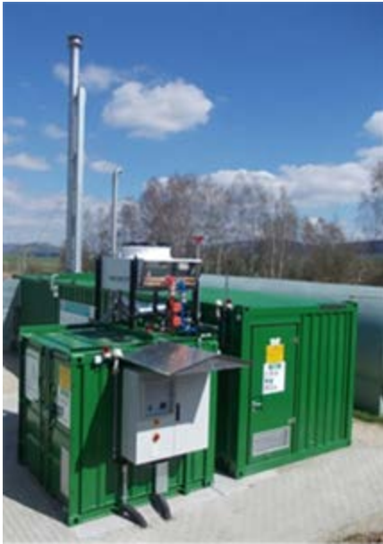
Abbildung 18: Anlage auf der Deponie Hüfingen (Quelle: LRA Schwarzwald-Baar-Kreis).
