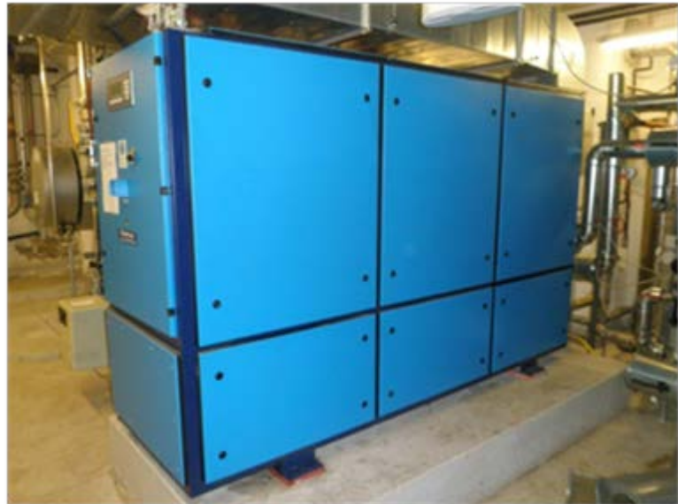
Bild 18: Blockheizkraftwerk (Stadt Stuttgart)
