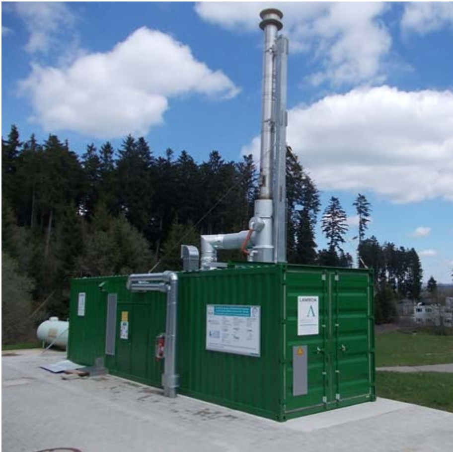
Bild 13: Anlage auf der Deponie Tuningen (Quelle: LRA Schwarzwald-Baar-Kreis)
