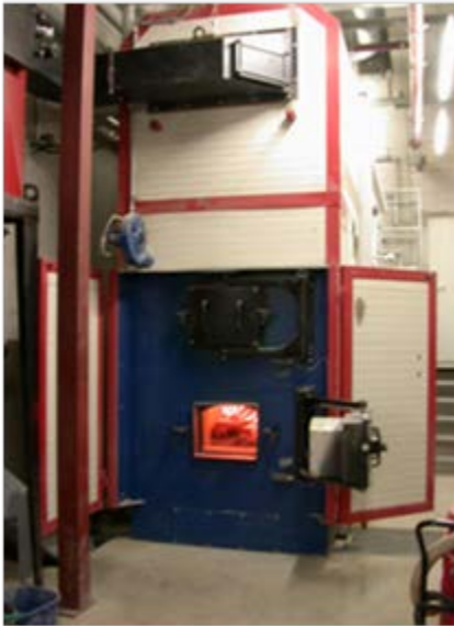
Bild 17: Holzhackschnittelheizung (Quelle: Stadt Stuttgart)
