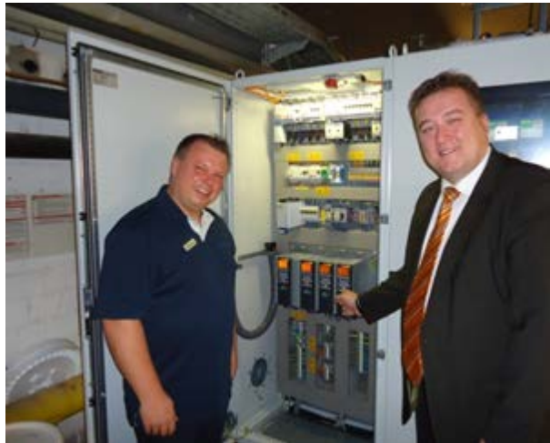
Bild 16: Technik mit hohem Einsparpotenzial: Nachträgliche Installation von Frequenzumformern für die Umwälzpumpen im Weiherhofbad (Quelle: Stadt Karlsruhe, Roland Fränkle)
