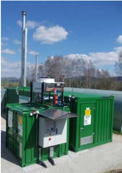
Bild 12: Anlage auf der Deponie Hüfingen (Quelle: LRA Schwarzwald-Baar-Kreis)
