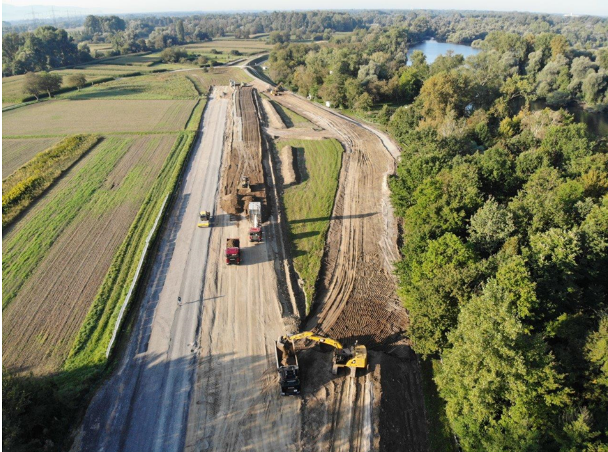
Abbildung 10: Dammertüchtigung des RHWD XXV im Regierungsbezirk Karlsruhe – Dammbegradigung Steinmauern Foto: Ingenieurbüro IQG
