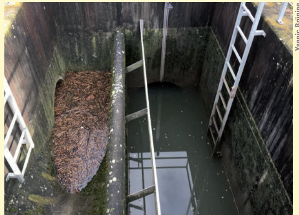
Beckenüberlauf eines Regenüberlaufbeckens. (links: Rückstau aus der Jagst, rechts: Mischwasserkanal)
