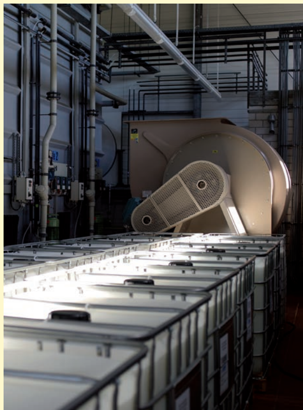
Fällmitteldosierstation zur Phosphor-Elimination in einer Kläranlage.
