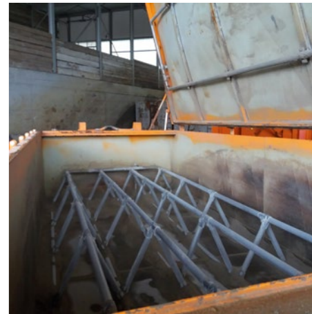
Innenansicht des Containers der Fa. Neustark AK zur Karbonatisierung der RC-GK
