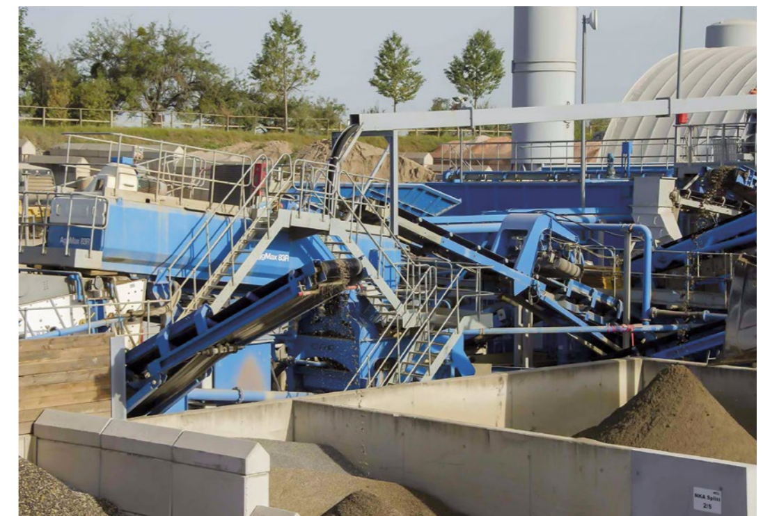
Nassklassieranlage der Fa. Feels
