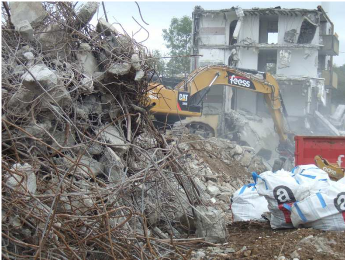
Abbildung 6.12: Getrennte Bereitstellung von Metallen und belasteten Materialien (in Big Bags)
