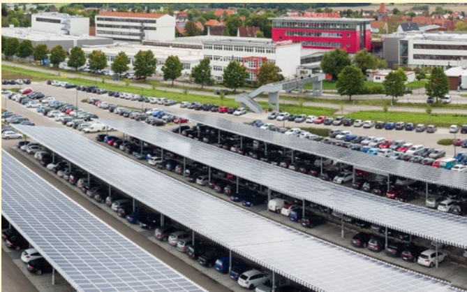
Photovoltaik-Parkplatz des Maschinenbauunternehmens Bausch+Ströbel in Ilshofen
