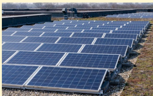
Die räumliche Trennung von Photovoltaikflächen und Dachbegrünung vereinfacht die Pflege und reduziert eine mögliche Verschattung durch den Bewuchs: dm-dialogicum in Karlsruhe.
