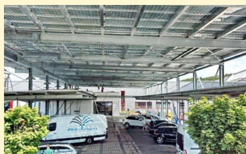
Solardach eines Waschparks in Tübingen
