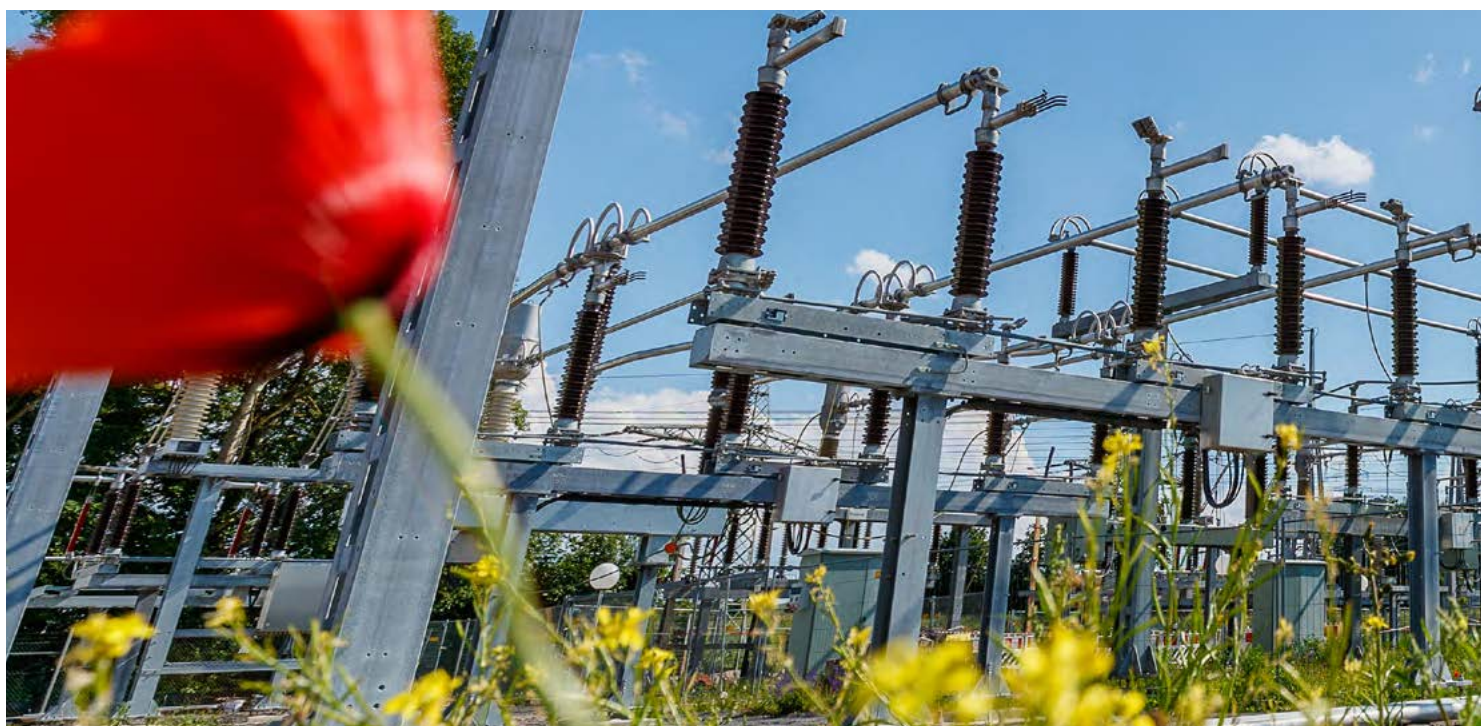
Bild: Umspannwerk Grossgartach Umspannanlage (© Björn Hänssler / Umweltministerium)
