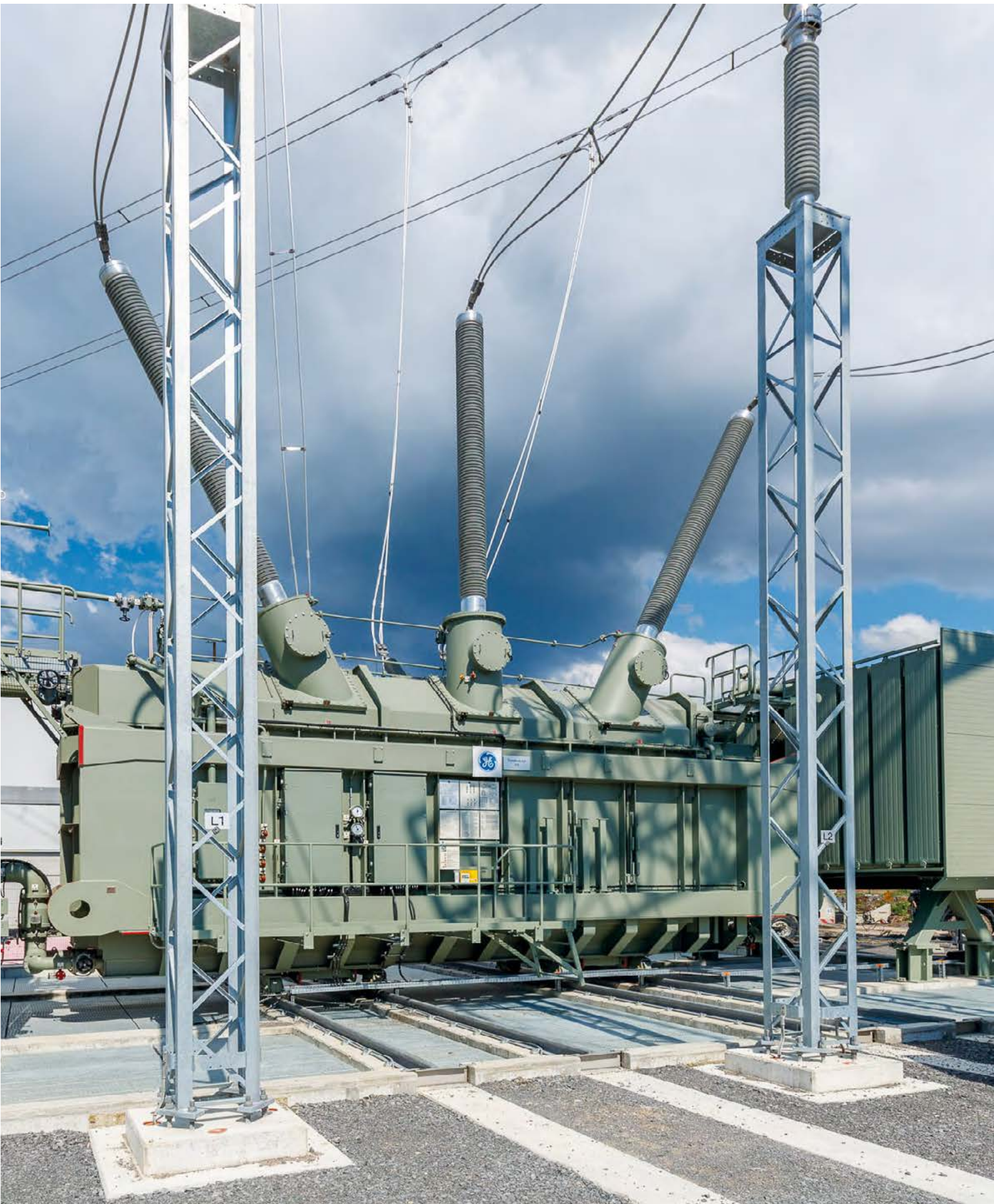
Bild: Trafo Umspannwerk Grossgartach (© Björn Hänssler / Umweltministerium)
