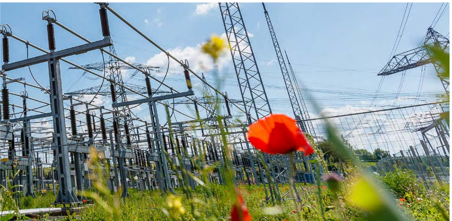
Bild: Umspannwerk Grossgartach Umspannanlage (© Björn Hänssler / Umweltministerium)
