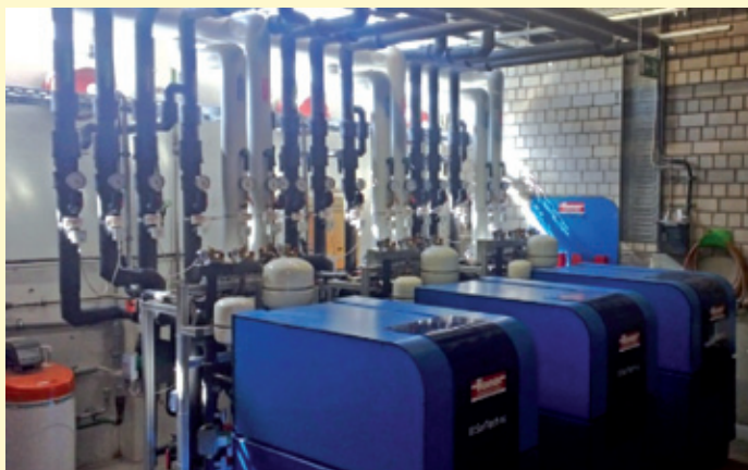
Bild: Honer lufttechnische Anlagen GmbH
