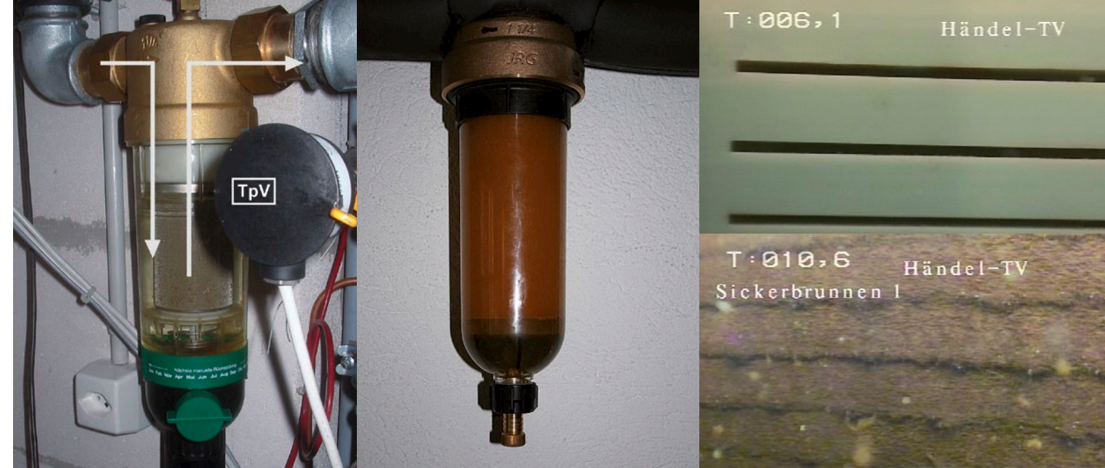
links: automatisch rückspülbarer Sandfilter im Vorlauf des Primärkreislaufs (TpV = Temperaturfühler primär Vorlauf); Mitte: Sandfilter, verstopft durch Eisenausfällungen (Eisengehalt des Grundwassers: 0,2 mg/l) Bildquelle: EBERHARD & Partner AG, CH-Aarau; rechts oben: sauberer Brunnenfilter, rechts unten: verockerter Brunnenfilter Bildquelle: W. Händel, Geophysikalische Bohrlochmessungen und Brunnen-TV, Ubstadt-Weiher
