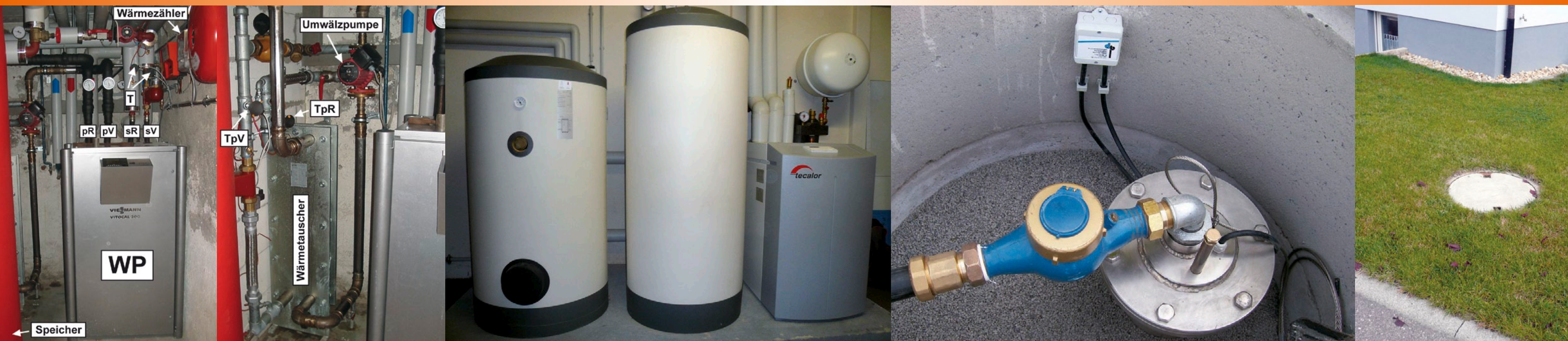
links: Überprüfung der Anlageneffizienz durch Messtechnik, Beispiel Wärmepumpenanlage „Pfarrgarten“ mit geschraubtem Trennwärmetauscher: Durchfluss-, Temperatur- und Wärmemengenerfassung im Primär- und Sekundärkreislauf (T = Temperaturfühler, pV = primär Vorlauf; pR = primär Rücklauf, sV = sekundär Vorlauf, sR = sekundär Rücklauf, WP = Wärmepumpe (Bildquelle: EBERHARD & Partner AG, CH-Aarau); rechts: Grundwasserwärmepumpe mit Speicher (Bildquelle: Ingenieurbüro Zoller, Forchheim/Kaiserstuhl)
