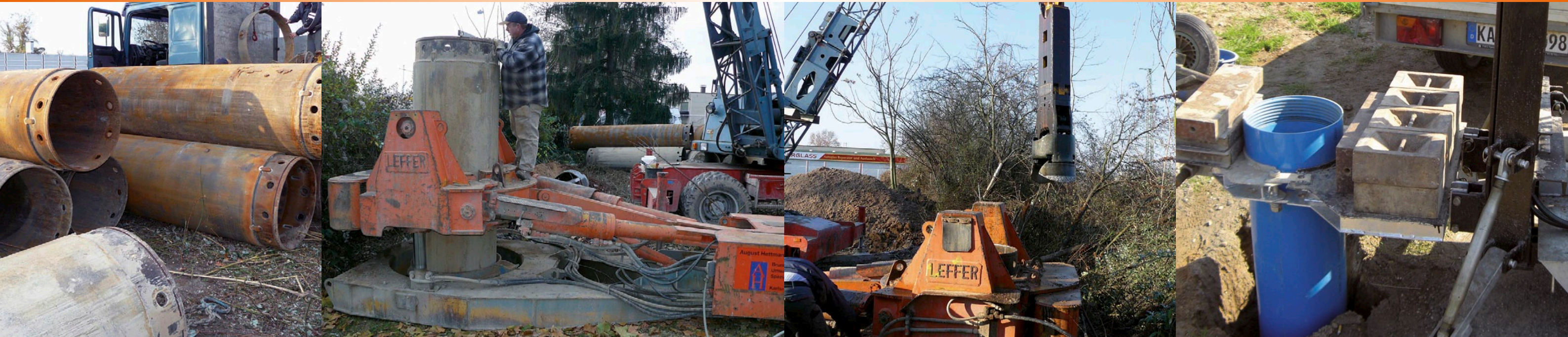
Brunnenbohrung, links: Stützverrohrung für einen großkalibrigen Grundwasserwärmbrunnen in Neckarschottern (Durchmesser 880 mm); rechts: Justierung der Stützverrohrung an der Verrohrungsmaschine des Bohreräts (Bildquellen: Dipl.-Geologe H. Weyersberg, Bietigheim-Bissingen).
