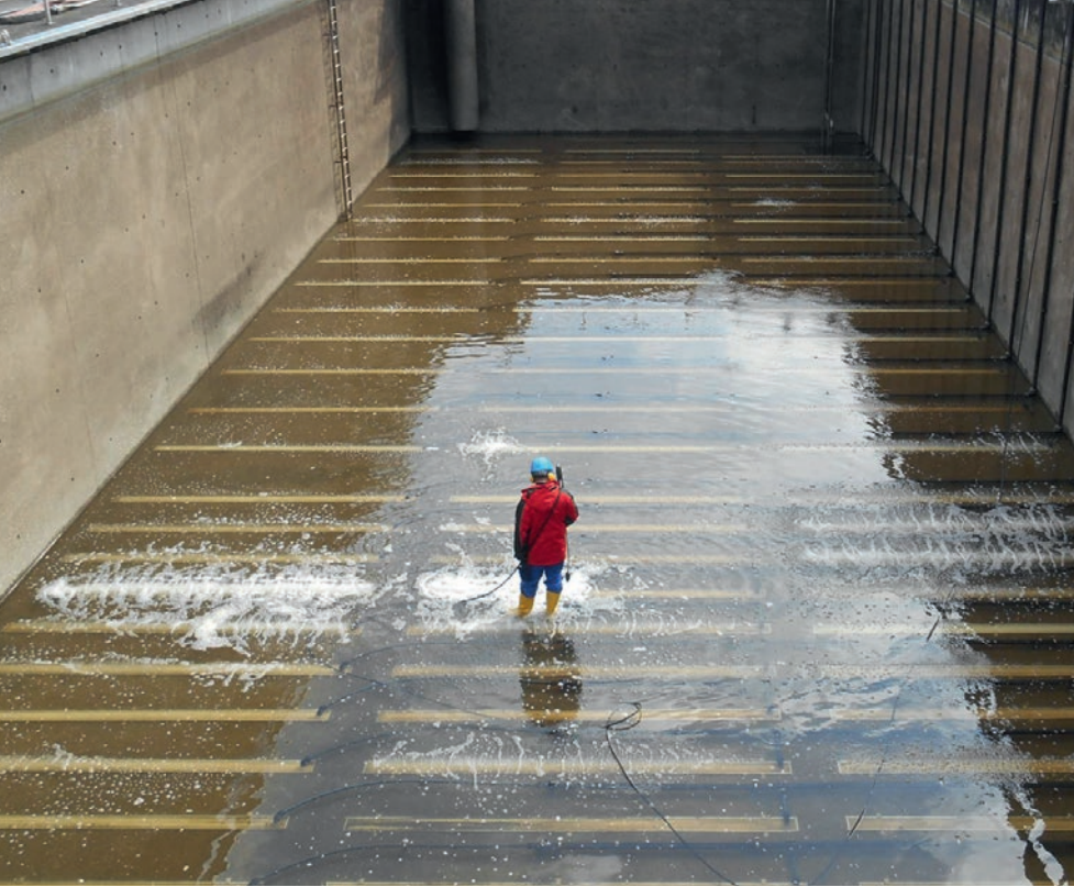
Abb. 13: Hochdruckreinigung von Belüfterelementen zur Vermeidung gradueller Druckanstiege infolge Belagbildung
